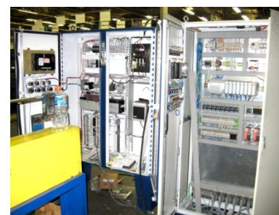
Автоматические системы управления
